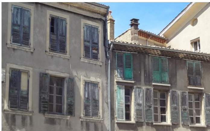
L'habitat dégradé dans le centre-ancien. © G2C Territoires
