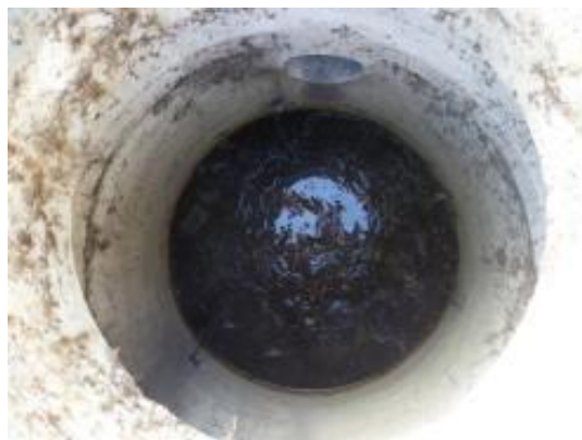
Figure 37 : Cliché d'un puits sec
